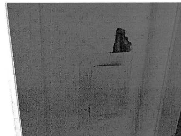
FOTO 18: APTO Nº 1106 – REPARO A SER REALIZADO
