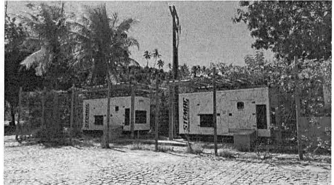
FOTO 58: GERADORES NA ENTRADA
