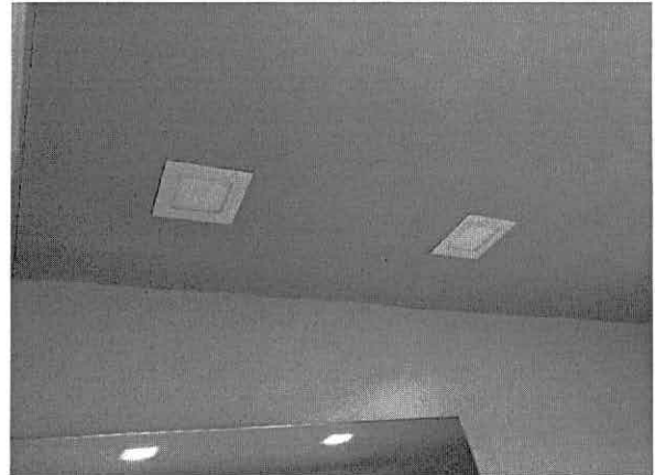
FOTO 62: SUÍTE 321 - INFILTRAÇÃO NO FORRO DO WC
