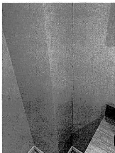
FOTO 59: SUÍTE 321 – TRINCA NA PAREDE
