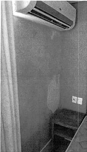
FOTO 45: APTO 172 – REPARO A SER REALIZADO
