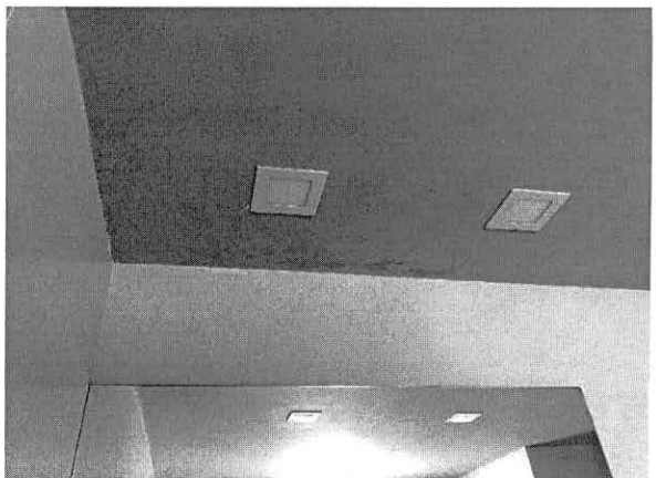
FOTO 42: SUÍTE 135 - INFILTRAÇÃO NO FORRO DO WC
