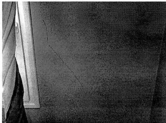
FOTO 58: SUÍTE 321 - TRINCA NA PAREDE
