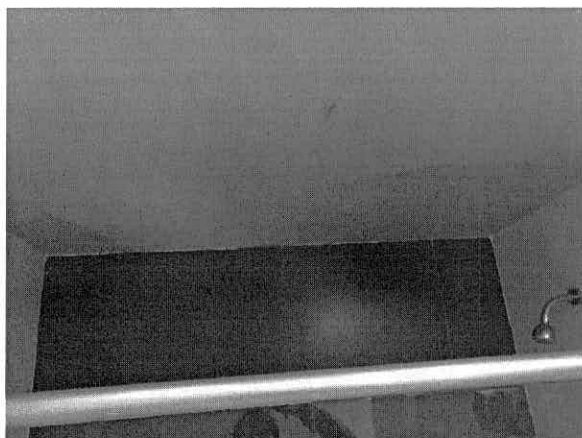
FOTO 74: SUÍTE 402 - INFILTRAÇÃO NO FORRO DO WC
