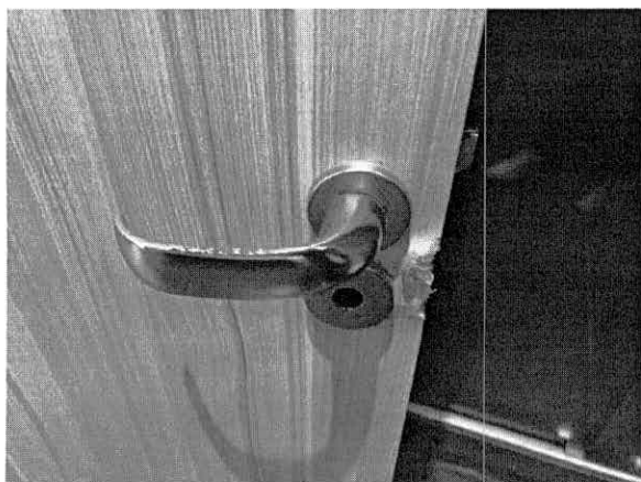
FOTO 73: PORTA DA SUÍTE 402 DANIFICADA
