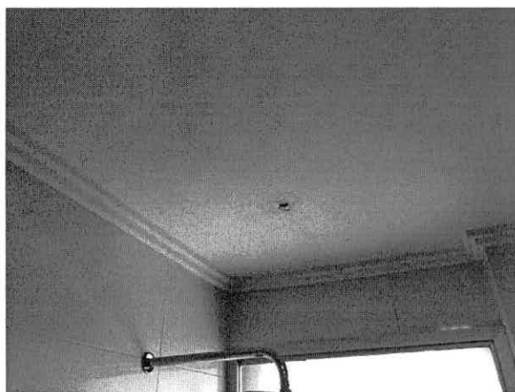
FOTO 14: APTO Nº 1101 – INFILTRAÇÃO NO FORRO DO WC
